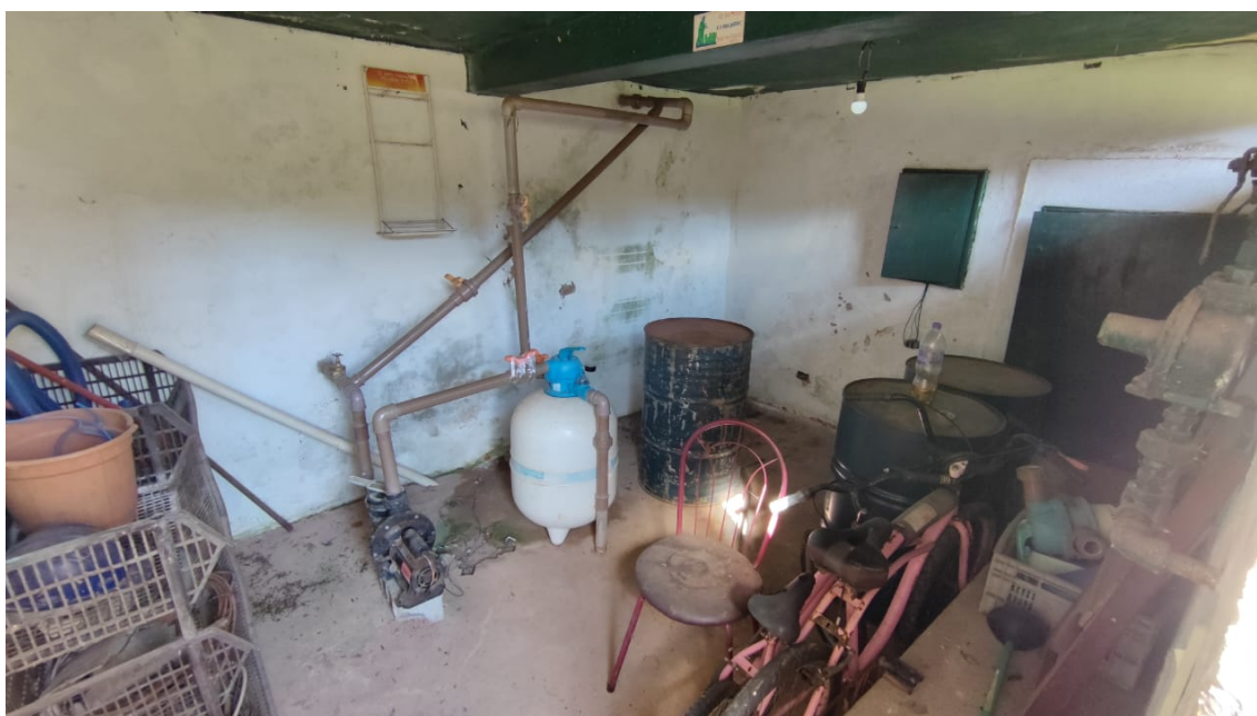
Vista interior casa de bombas da piscina
