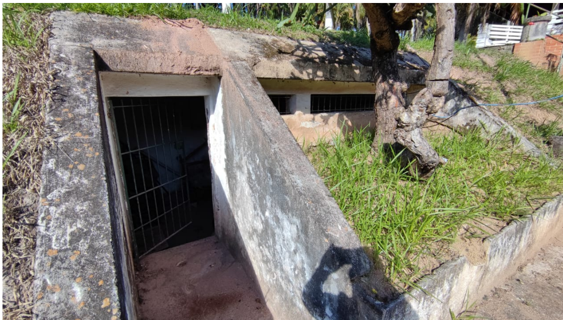
Acesso a casa de bombas piscina
